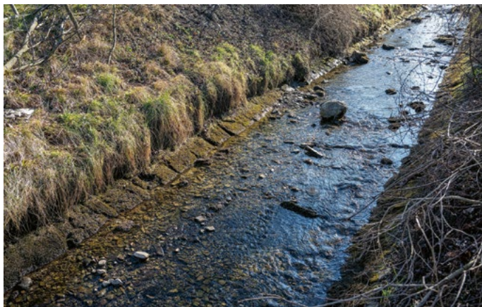
Verbautes Gerinne im Grundzustand, fotografiert im «Sunk-Zustand».
