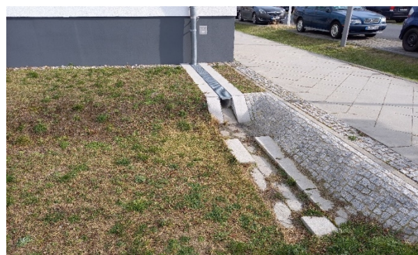
Abbildung 2: Einleitung von Dach- und Fassadenwasser in eine begrünte Versickerungsfläche
