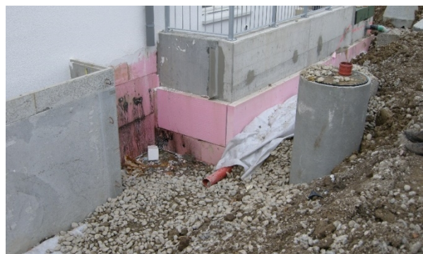
Abbildung 7: Muldenversickerung mit Anschluss an die Mischkanalisation
