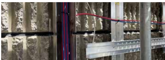
Abb. 64: Horizontale Elementfuge zwischen den vorgehängten Betonelementen der Fassade (© Silvia Domingo Irigoyen)
