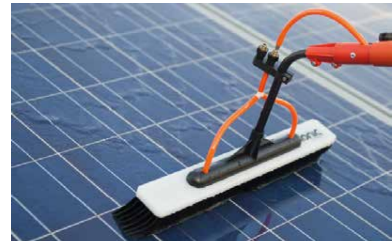
Abb. 51: PV-Module sind i.d.R. wartungsarm, eine regelmässige Reinigung der Anlage ist jedoch wichtig, um ein ansprechendes Erscheinungsbild und eine hohe Effizienz zu erreichen (© ADU Service Gruppe)
