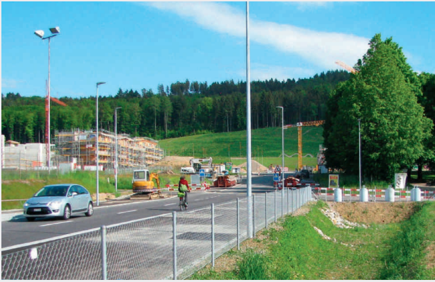
Fig. 2 Die Entwässerung der Erschliessungsstrassen im Neubaugebiet Oberfeld erfolgt über diese neu erstellte Versickerungsmulde L'évacuation des eaux des routes de desserte du nouveau quartier en construction Oberfeld se fait par l'intermédiaire de cette cuvette d'infiltration nouvellement réalisée
