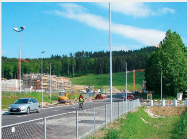
Fig. 2 L'évacuation des eaux de routes de desserte du nouveau quartier en construction Oberfeld se fait par l'intermédiaire de cette cuvette d'infiltration nouvellement réalisée.
