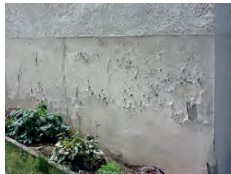
Anstrichablösung im Sockelbereich
