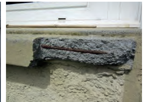
Kunststeinfensterbank mit Fehlstelle
