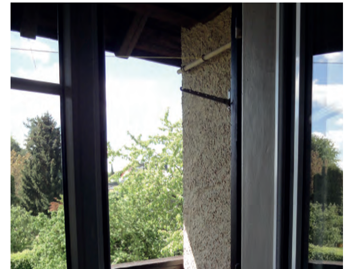
Fotos von Zustandsaufnahme
