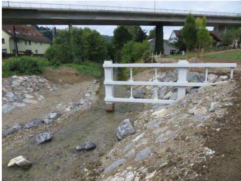
Abbildung 11: Schwemmholtzrückhalt in der Linkskurve der Eulach in Elsau-Räterschen (Quelle: AWEL)
