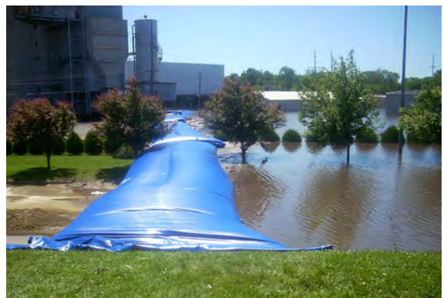
Abb. 93: Mobiler, mit Wasser gefüllter Schutzdamm
