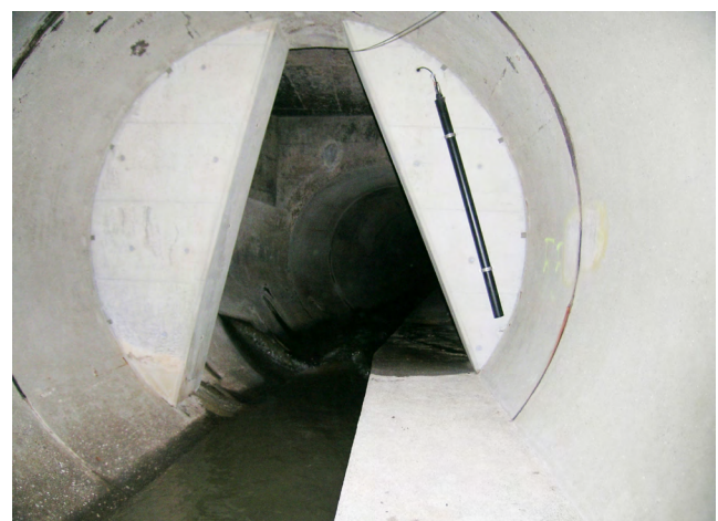
Abb. 72: Zulaufkanal in Köniz mit Drosselblende. Im schwarzen Schutzrohr befindet sich eine Sonde zur Wasserstandsmessung.
