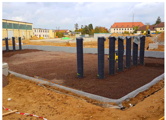
Abb. 67: Die untersten Lagen bestehen aus Stoffelementen (Löschwassernutzung), die weitere Auffüllung hier aus Lava (hohes Porenvolumen).
